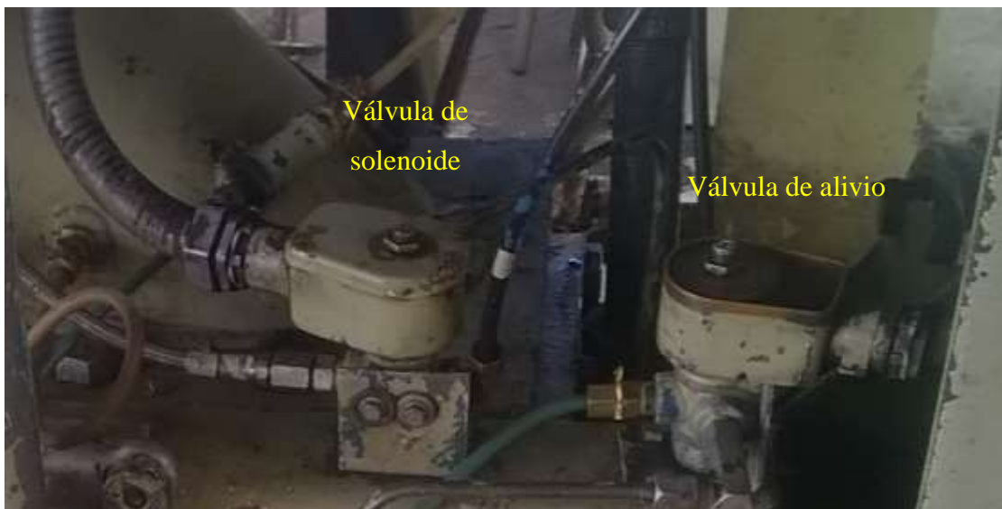
Figura 42: Válvulas hidráulicas. Fuente propia (2018)
