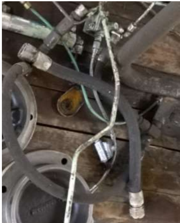
Figura 15: Mangueras hidráulicas. Fuente propia (2018)
