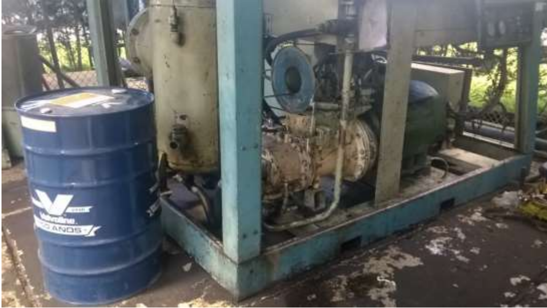
Figura 43: Conjunto compresor. Fuente propia (2018)
