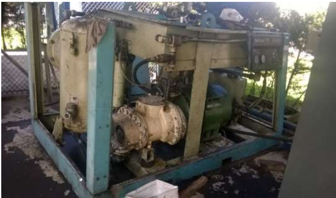
Figura 14: Unidad de compresor en estado inicial. Fuente propia (2018)
