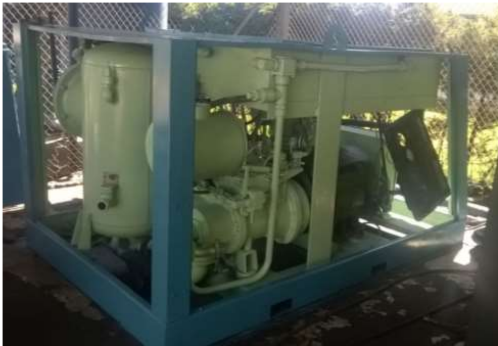
Figura 33: Conjunto compresor finalizado. Fuente propia (2018)
