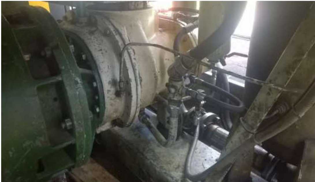
Figura 31: Vista lateral izquierda de los elementos hidráulicos instalados. Fuente propia (2018)
