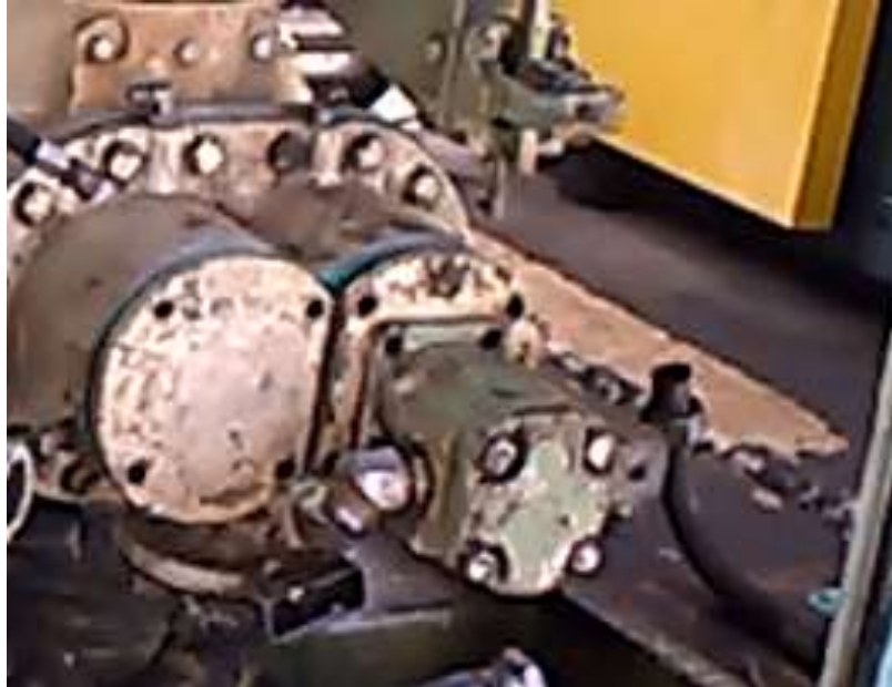
Figura 26: Bomba hidráulica instalada. Fuente propia (2018)
