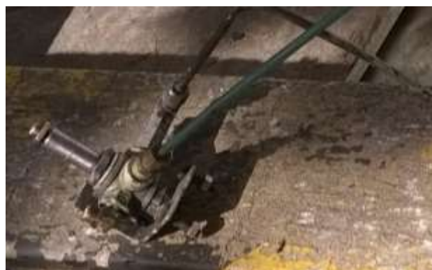
Figura 19: Válvula de alivio. Fuente propia (2018)
