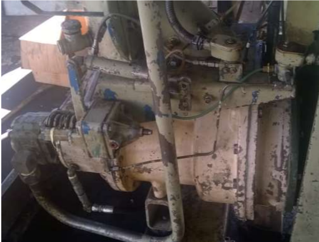
Figura 32: Vista lateral derecha de los elementos hidráulicos instalados. Fuente propia (2018)
