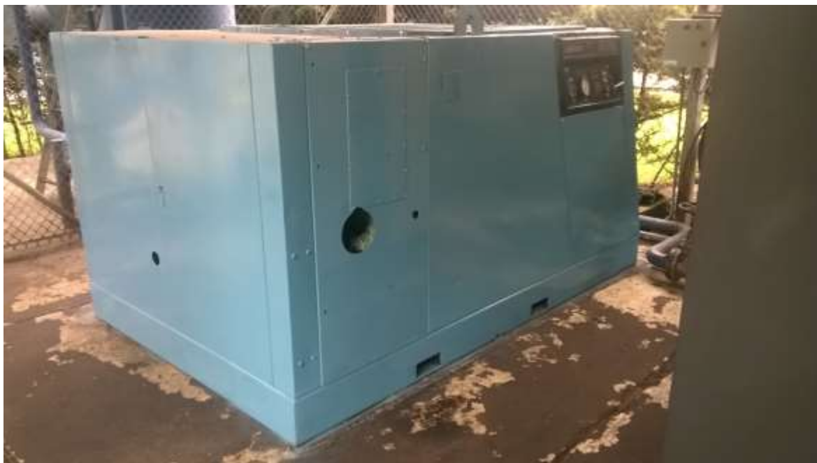
Figura 45: Conjunto compresor finalizado. Fuente propia (2018)
