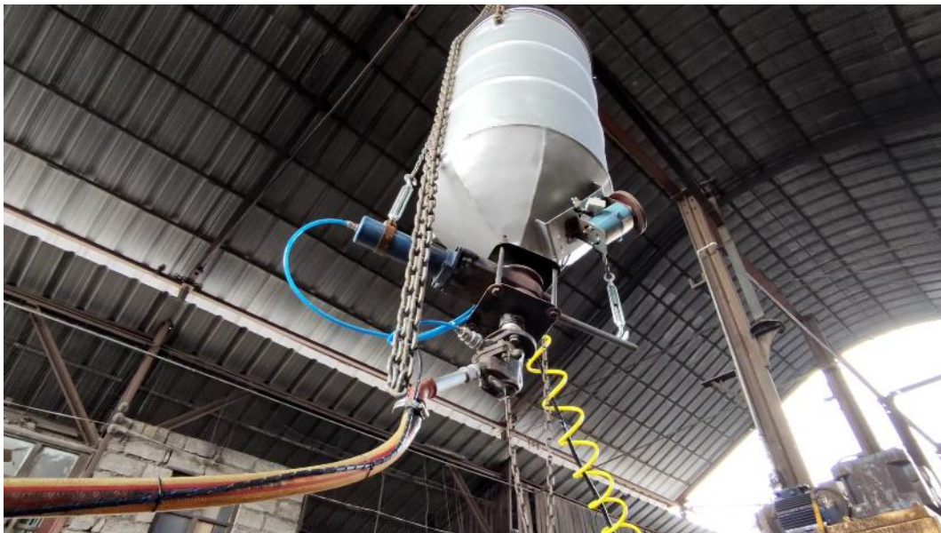
Anexo No. 15 Sistema semiautomático surtidor de arena sílica en funcionamiento Elaborado por: Paul Fernando Naranjo Torres Fuente: Propia
