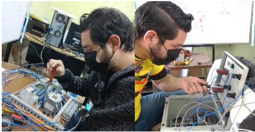
Imagen No. 37 Conexión eléctrica de todos los elementos del tablero. Elaborado por: Paul Fernando Naranjo Torres Fuente: Propia.
