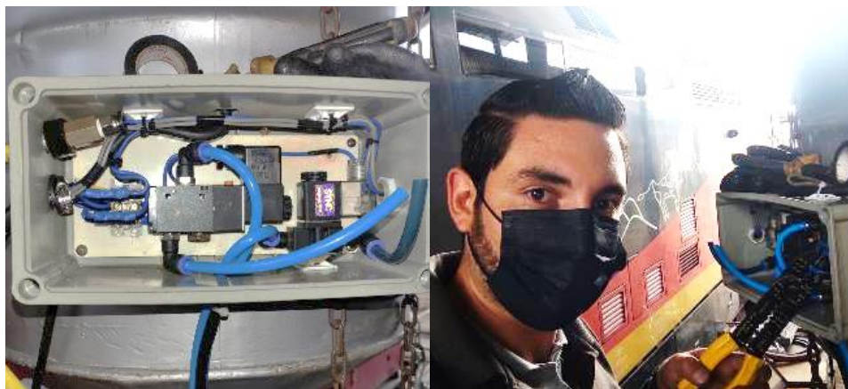
Imagen No. 42 Conexión del tablero de distribución. Elaborado por: Paul Fernando Naranjo Torres Fuente: Propia.
