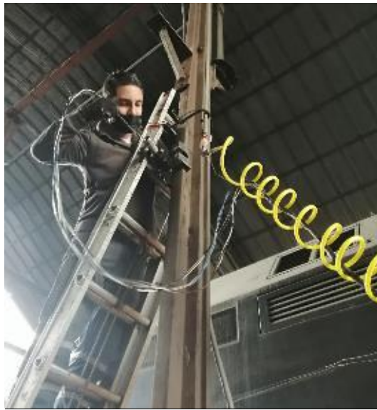
Imagen No. 41 Cableado del sistema eléctrico. Elaborado por: Paul Fernando Naranjo Torres Fuente: Propia.
