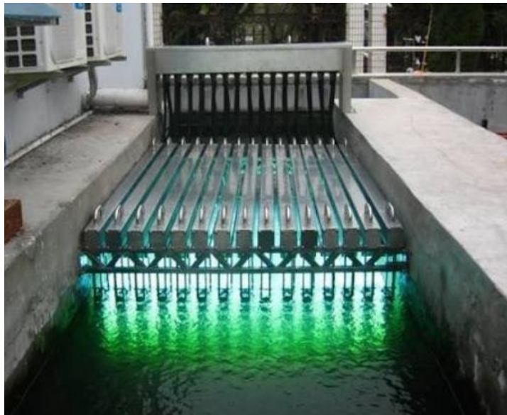
Imagen No. 3 Desinfección de agua. Elaborado por: Tssinternacional Fuente: Datos de la investigación
