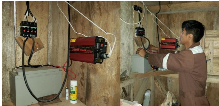
Imagen N° 38 Sistema instalado dentro de la vivienda.
