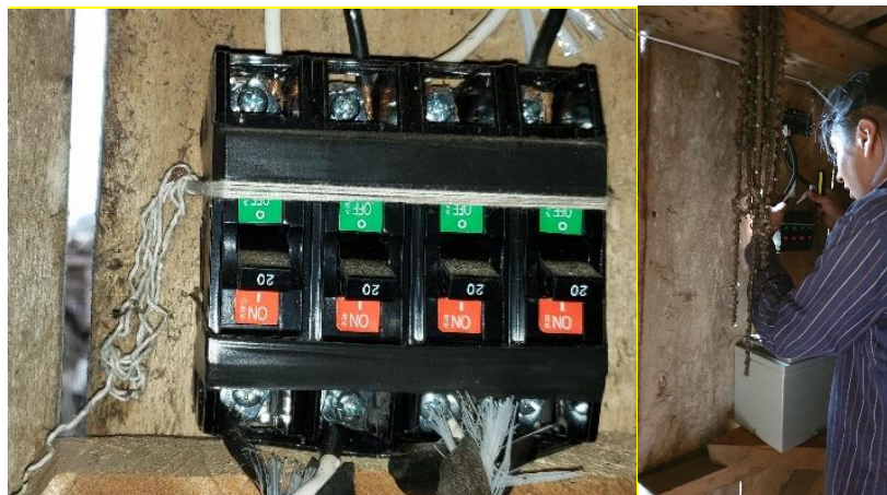
Imagen N° 29 Protección del sistema solar fotovoltaico.
