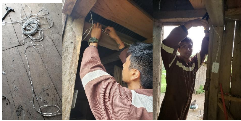
Imagen N° 26 Cableado de la vivienda beneficiada.
