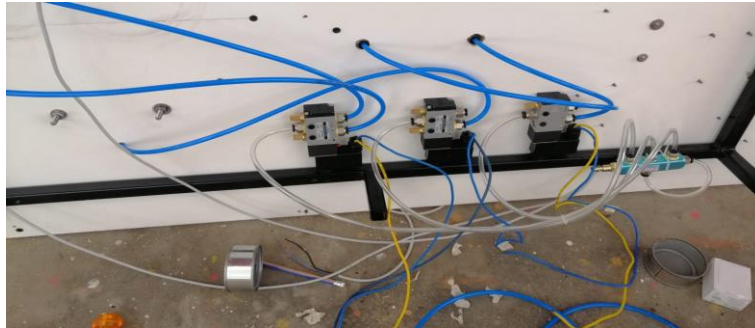
Figura 38: Cableado de electroválvulas y mangueras PU
