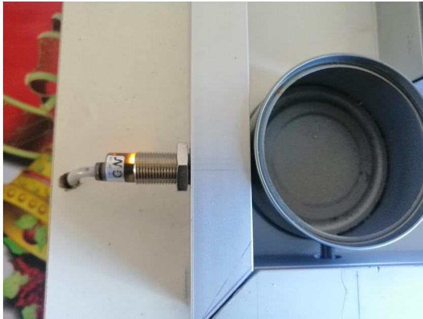
Figura 49: Prueba de funcionamiento de sensor
