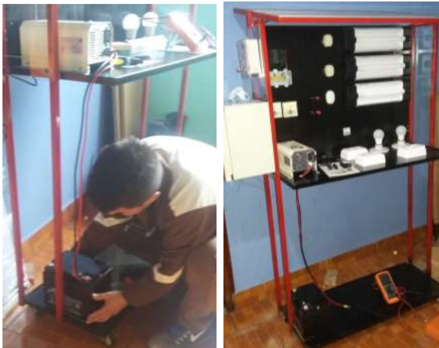
Figura 32: Banco de batería 12Vcc-40Ah. Elaboración propia, (2019).
