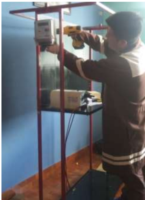
Figura 24: Medidor KWh CA. Elaboración propia, (2019).
