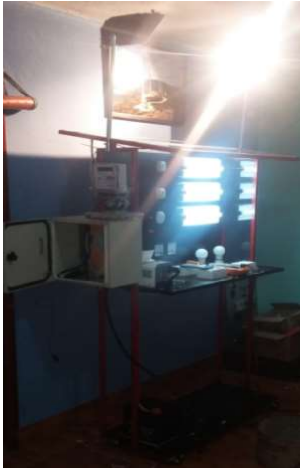
Figura 34: Módulo de energía solar FV funcionando. Elaboración propia, (2019).
