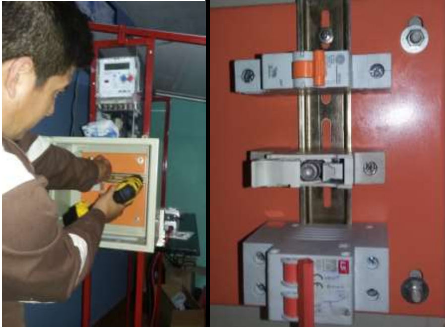
Figura 25: Caja de disyuntores CA. Elaboración propia, (2019).
