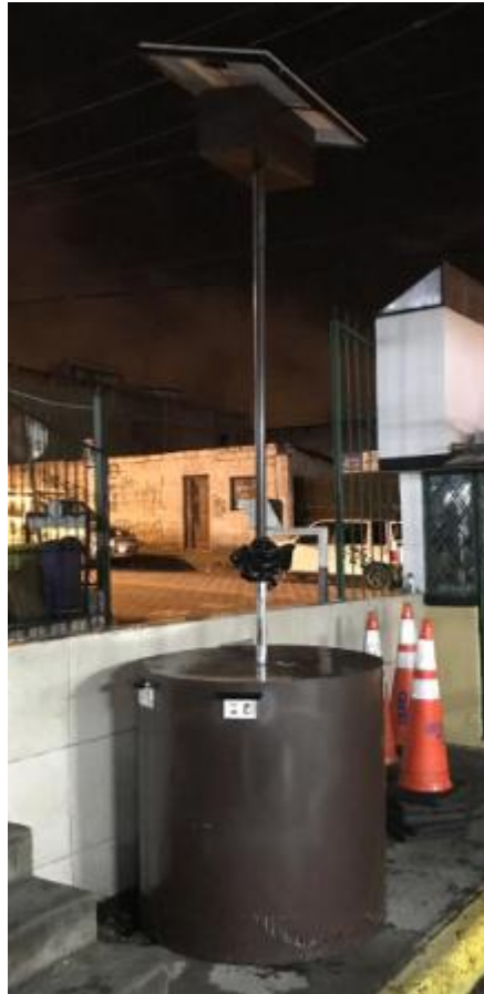
Figura 22: Sistema instalado en el Instituto Superior Vida Nueva Elaboración propia, (2019)
