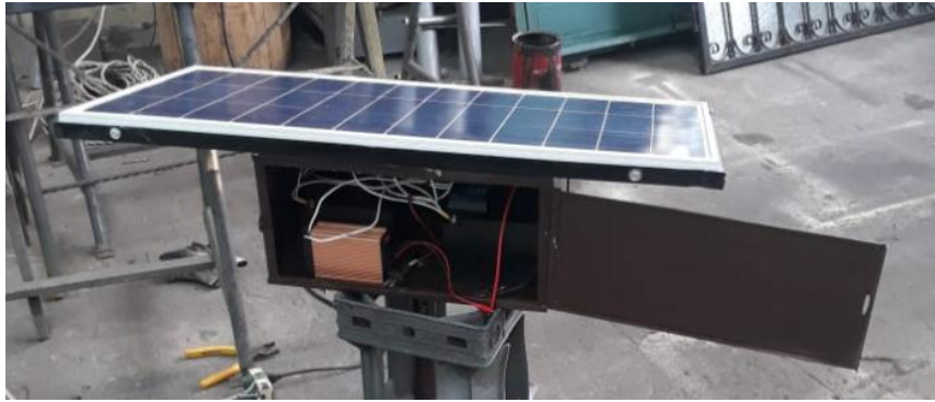
Figura 20: Sistema de energía eléctrica con un panel solar (Elaboración propia, 2019)
