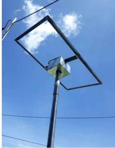
Figura 16: Soporte para el panel solar (Elaboración propia, 2019)
