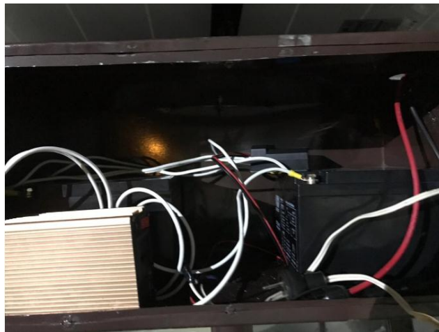
Figura 19: Conexión del controlador solar, la batería y el inversor. (Elaboración propia, 2019)
