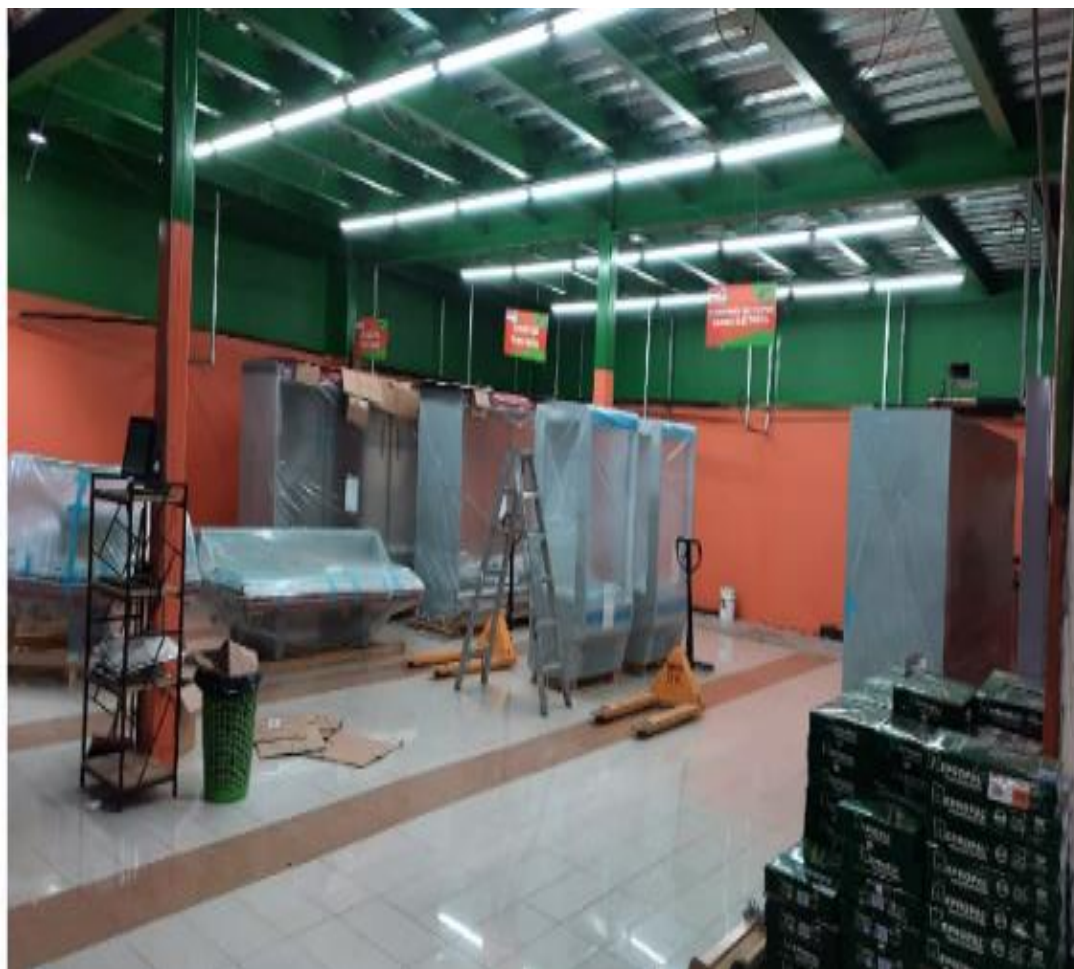
Ubicación de Equipos Frigoríficos
