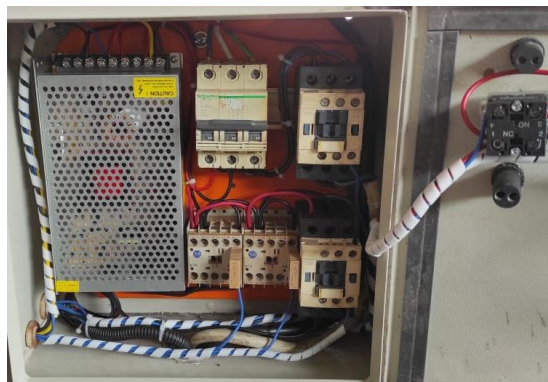
Imagen No. 31 Organización del Cableado
