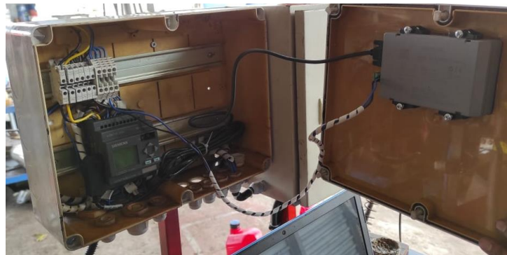
Imagen No. 35 Conexión entre el PLC y HMI LOGO
