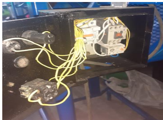
Imagen No. 43 Accionamiento de encendido y apagado Elaborado por: Bautista Alvarez Nixon Flavio Fuente: Datos de la investigación
