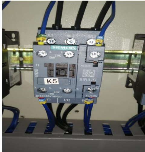
Imagen No. 10 Contactor marca SIEMENS Elaborado por: Marco Santiago Mendoza Casa Fuente: Datos de la investigación
