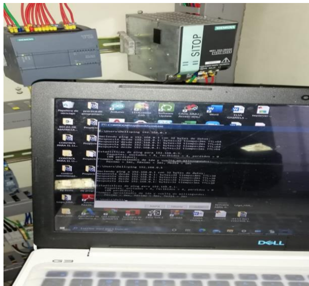
Imagen No. 34 Medición de voltajes Elaborado por: Marco Santiago Mendoza Casa Fuente: Datos de la investigación
