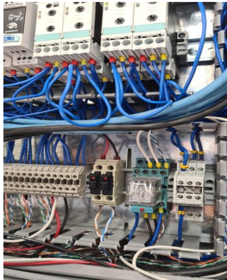
Imagen No. 44 Conexión del relé de monitoreo Elaborado por: Mendoza Casa Marco Santiago Fuente: Datos de la investigación
