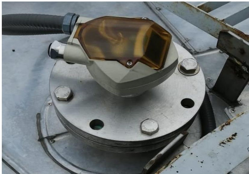
Imagen No. 16 Transmisor de nivel
