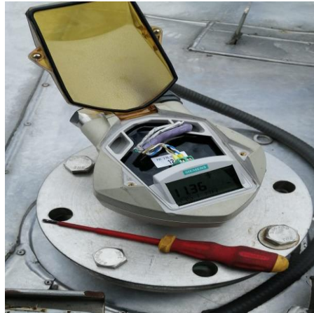
Imagen No. 18 Instalación del transmisor de nivel Elaborado por: Marco Santiago Mendoza Casa Fuente: Datos de la investigación
