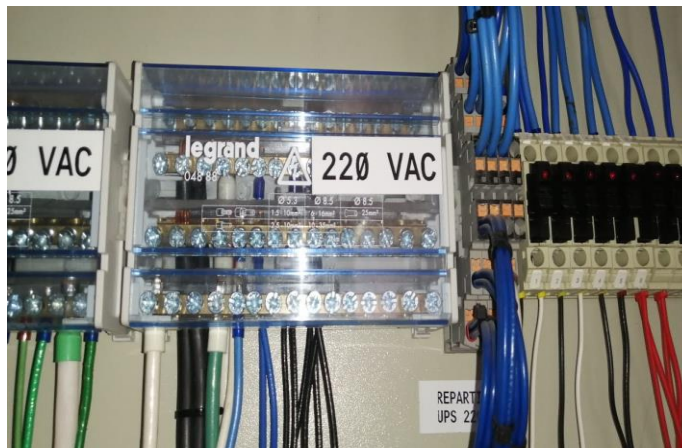
Imagen No. 19 Repartidor de cargas eléctricas Elaborado por: Marco Santiago Mendoza Casa Fuente: Datos de la investigación
