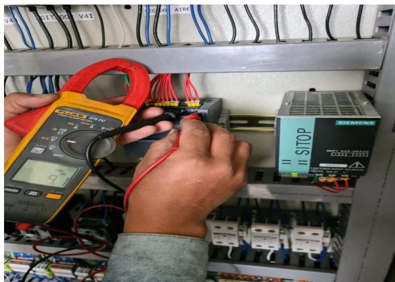
Imagen No. 39 Medición del voltaje en PLC Elaborado por: Mendoza Casa Marco Santiago Fuente: Datos de la investigación
